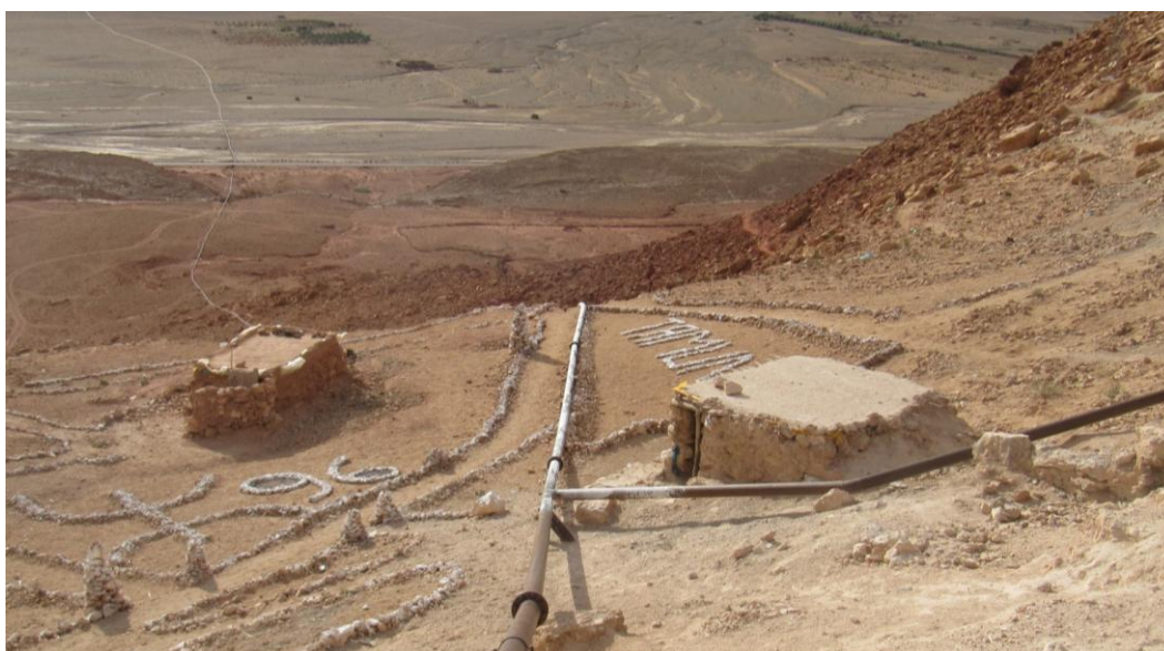
Canalisations acheminant l'eau vers la mine
